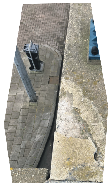
Het beton van de aanlandingen in de veerhaven is op sommige plaatsen niet meer in goede staat
