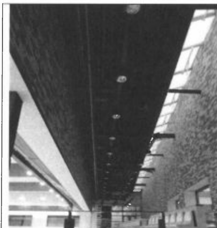
Foto 6: De materiaalkeuze van de bevestiging van de lichtarmaturen is onbekend. De plaatsing maakt de armaturen en bevestiging gevoelig voor SCC aantasting.
