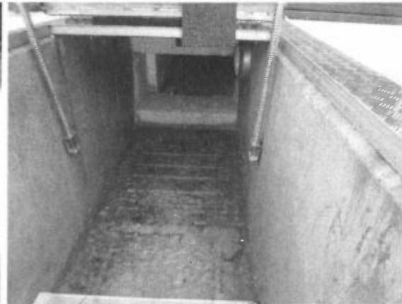
Figuur 4.12: Put naar kruipruimte met water op de vloer. Vanuit de metalen rand zijn vuilsporen te zien die duiden op lekkage.
