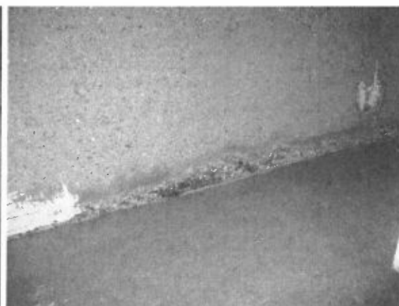
Figuur 4.8: Wand-vloer aansluiting met schade en reparatieplekken.
