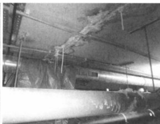
Figuur 4.2: Kalklekkages uit langsnaden breedplaatvloeren.
