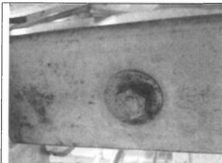
Foto 11: De bouten van de bevestiging van de lage duikplank op het frame vertoont aantasting. Het indrogend zwembadwater geeft een hoge concentratie chloor op het oppervlak waardoor de aantasting plaatsvindt.
