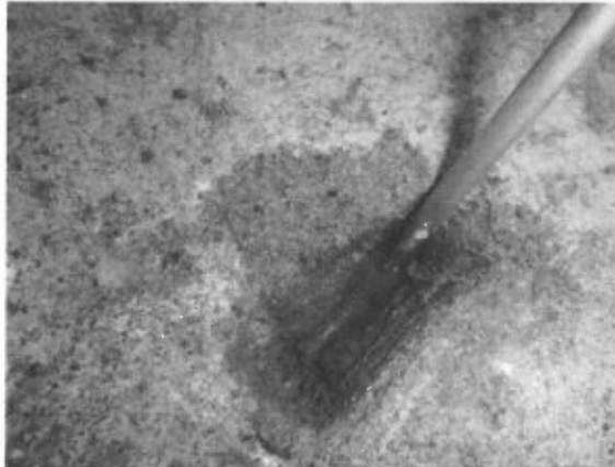
Figuur 5.3: Water zichtbaar, onderin de mortel, op de betonvloer.
