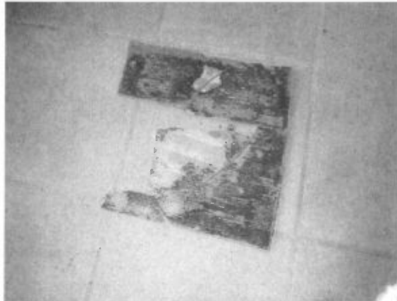
Figuur 5.4: Onderzijde verwijderde tegel. Het losse middendeel is wit gebleven.
