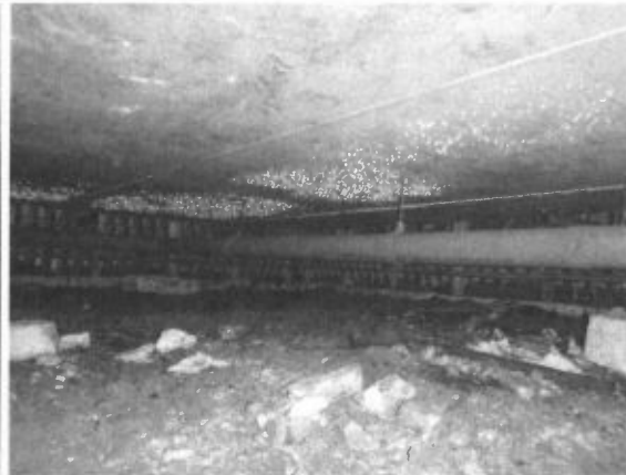
Figuur 4.16: Vlekken en condens op isolatie onder perron wedstrijd-bassin in hoek gevel.
