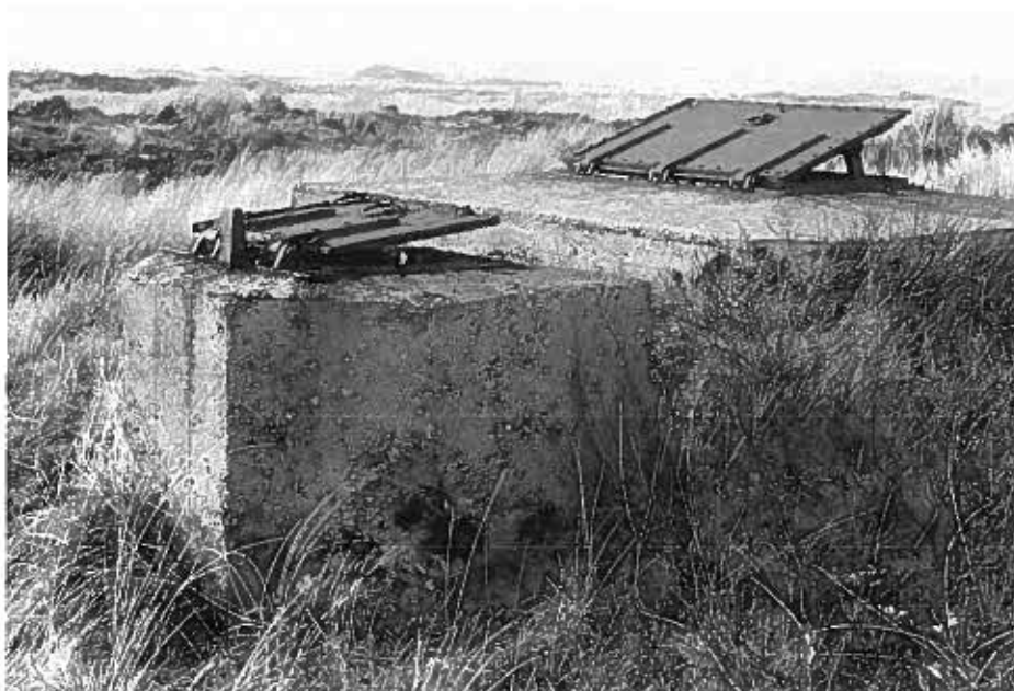
99 Den Helder-Huisduinen, Stelling van Den Helder, noordelijk emplacement en munitiemagazijn (in situatie nr. 9), naar ZW, foto 1986.
