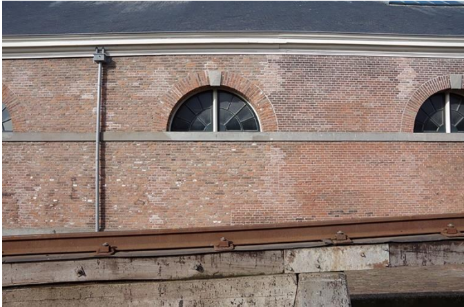
33 Detail metselwerk oostgevel. Het zuidelijk deel is in 1952 opnieuw opgemetseld met oude stenen.
