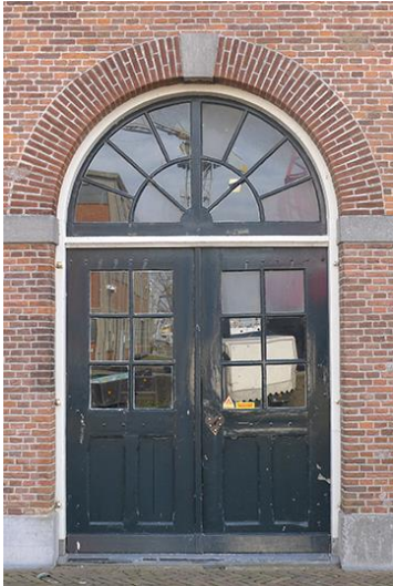
77 Oorspronkelijke deur aan de noordzijde. Het kozijn is wit geschilderd en de deuren en het bovenlicht zijn donkergroen van kleur.
