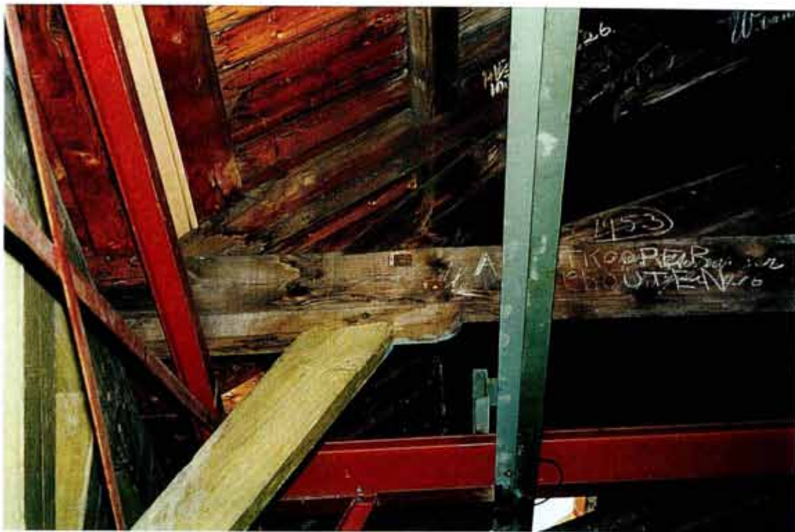
Afb. 20 Overzicht van de oplegging van een spant (zie afb. 18). De trek balk (A) van het spant ligt op op een sleutelstuk (B) met kwartrond-profilering (C). Deze ligt op zijn beurt op op de dekbalk (D) van de standvink-constructie (E). Het sleutelstuk wordt ondersteund door een schoor (F). Op het uiteinde van de trek balk ligt de gootbodem (G). Zichtbaar zijn verder het spantbeen (H), het korbeel van het onderste spant (I), de aanloper (K) en de middenstijlschoor (L).
