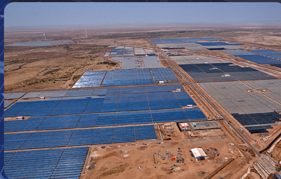
Solarpark Gujarat (India), het grootste zonnepark ter wereld. Bron: www.hcp.co.in
